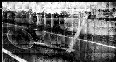
写真-2: 傾倒した照明柱と衝突事故現場の例
