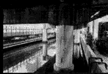
写真-9 橋下空間が狭く、騒音傾向が大きい
