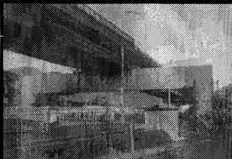
写真-4: 西条駅前電柱を貫する疲労(ラーメン橋脚の中)
