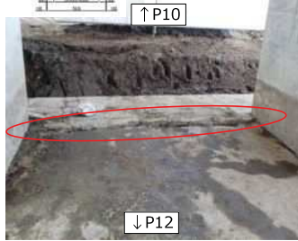
フーチング上面の亀裂
