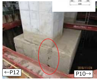
フーチング側面(中分側)の亀裂
